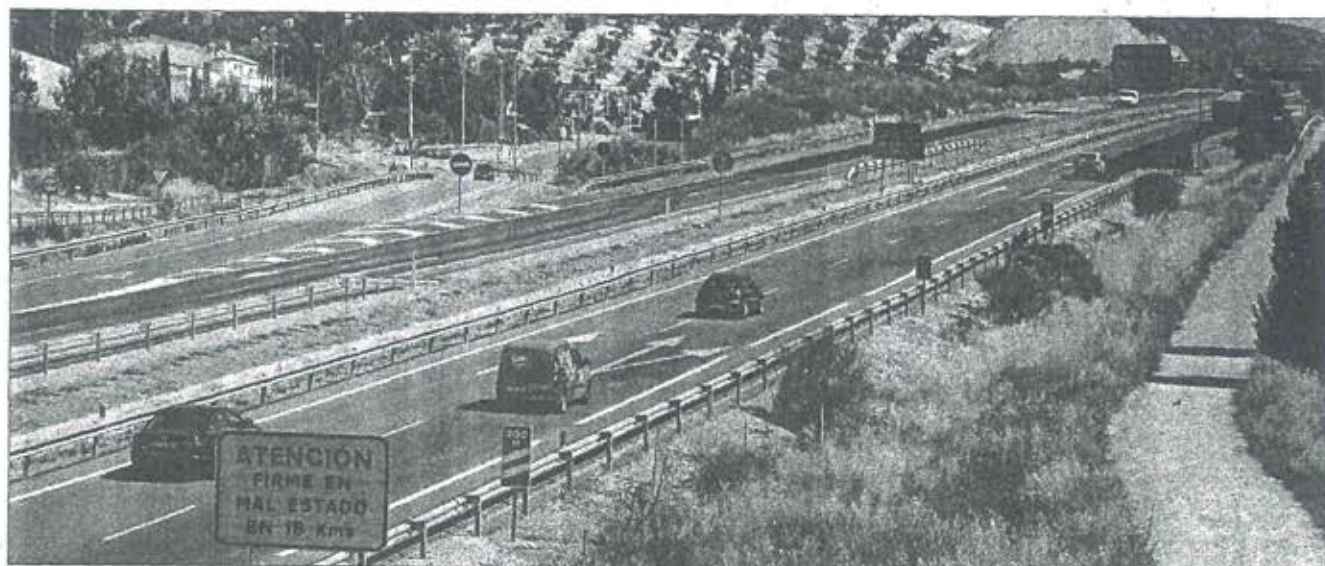
CARRETERA. Estado de los trabajos de reparación del firme de la autovía antes de llegar a Noalejo, en el punto kilométrico 77.
